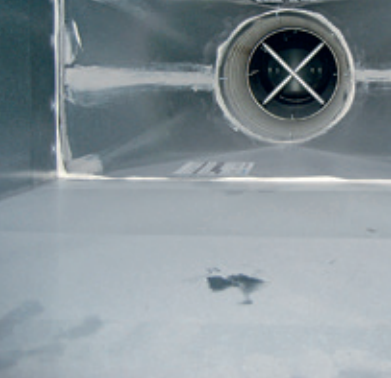
Neu installierter, bauseits verschmutzter Lüftungskanal
