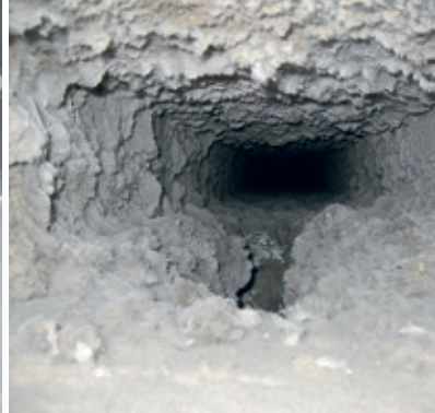
Schmutzablagerungen in einem Luftkanal bei unsachgemässer Wartung
